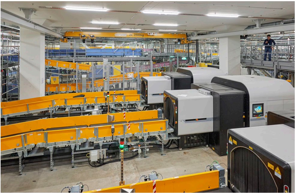
Neue CT-Scanner in der Gepäcksortieranlage
